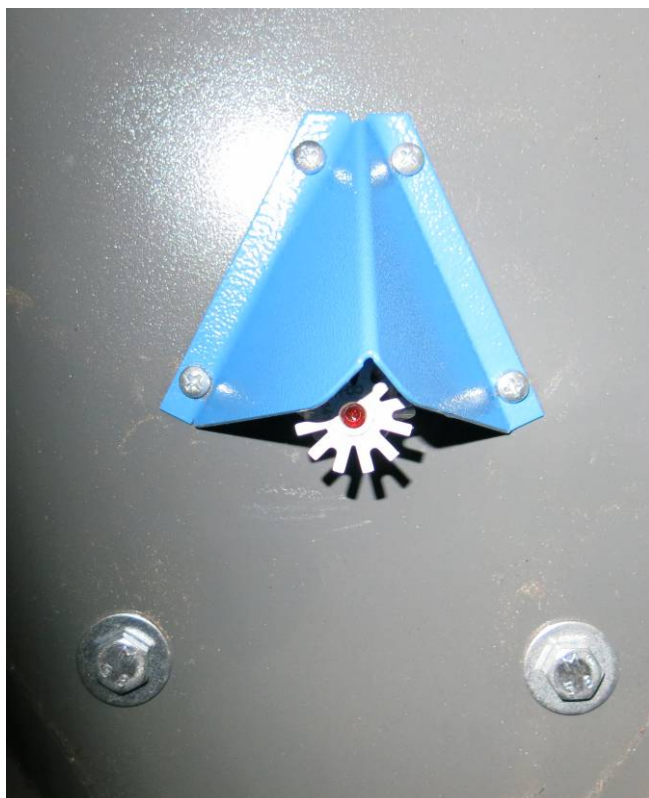
а) система пожаротушения в бункере
