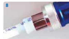
8 Расширяйте трубу с кольцом до тех пор, пока торец трубы не упрется в торец расширительной головки
